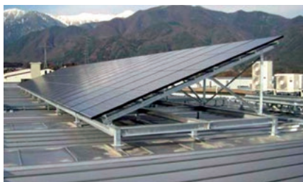
DDS駒ヶ根工場 (20kW) 2008年稼働開始
