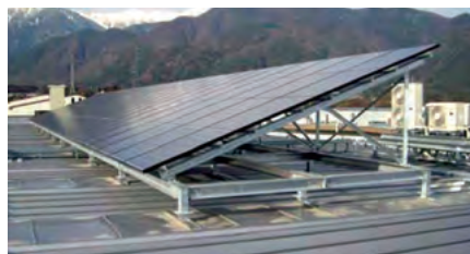
DDS駒ヶ根工場 (20kW) 2008年稼働開始
