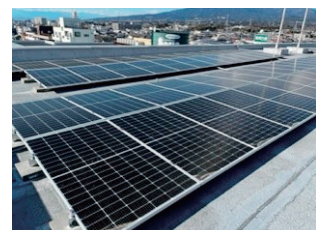
太陽光パネル
