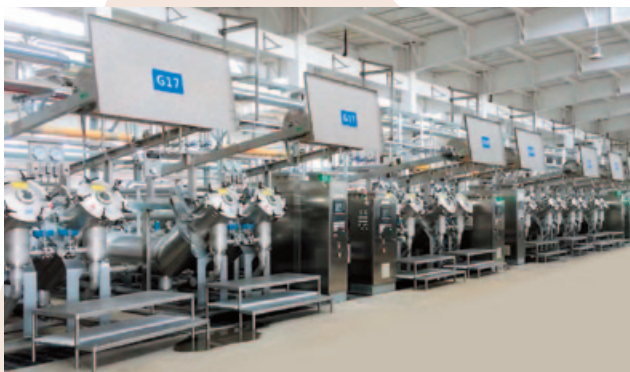
中国の染色工場稼働中の液流染色機「サーキュラー」
