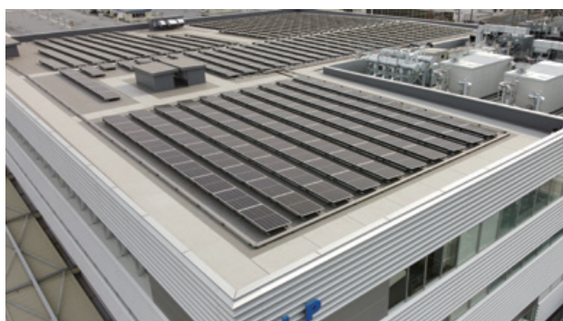
藤沢事業場 NP棟太陽光発電
