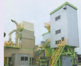
石膏系固材製造設備 乾燥した石膏粉から半水石膏を製造し、セメントや石灰とブレンドすることで固材を製造するプラント設備
