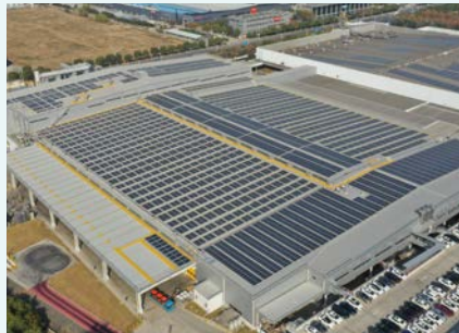
設置した太陽光パネル
