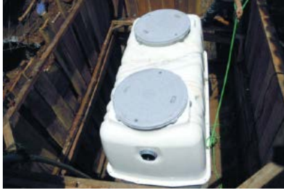
戸建住宅への小型浄化槽導入事例(インドネシア)
