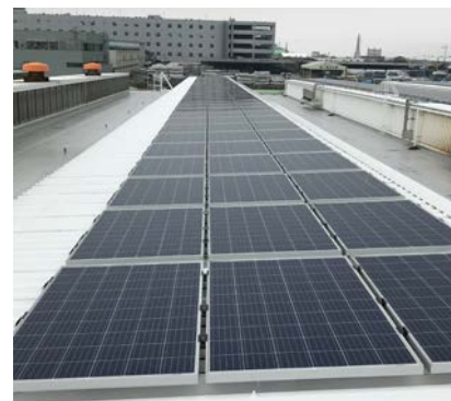
太陽光発電システムの設置 クボタ堺臨海工場
