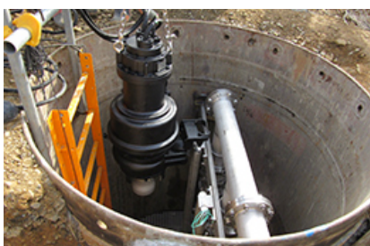
マンホールポンプ(下水を圧送)
