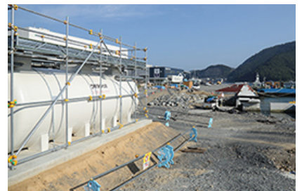
浄化槽(下水道が整備されていない地域、仮設住宅等の排水処理に活用)
