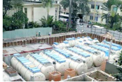
病院への大型浄化槽導入事例(ベトナム)
