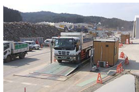
トラックスケール（トラックに積載された瓦礫などの重量を計測）
