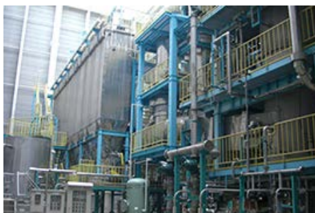
水処理プラント（生活排水・産業排水等を処理）
