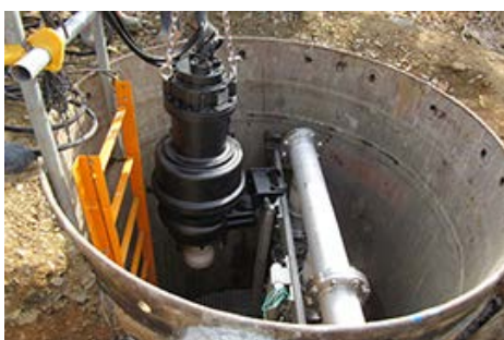
マンホールポンプ（下水を圧送）
