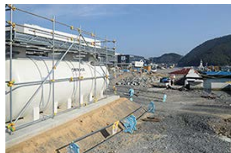
浄化槽（下水道が整備されていない地域、仮設住宅等の排水処理に活用）
