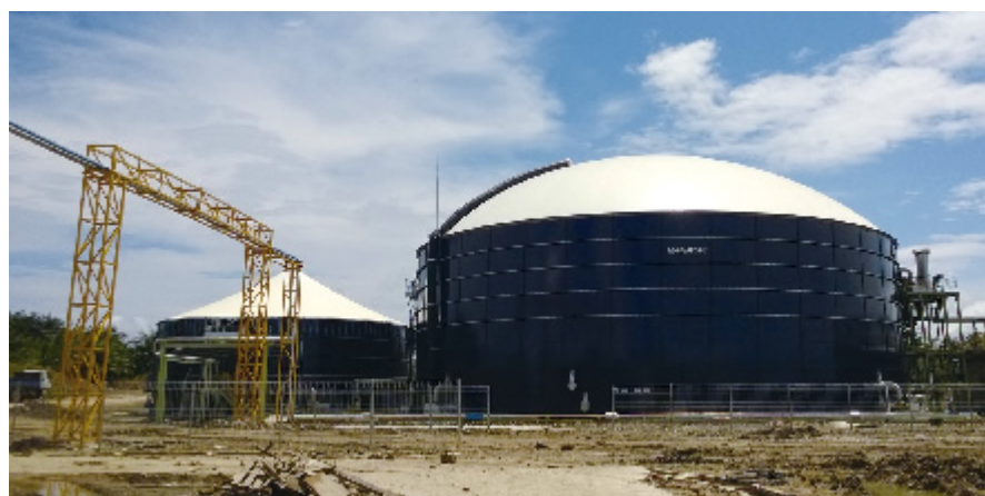
マレーシア(BBC Biogas社向け)バイオガス回収設備
