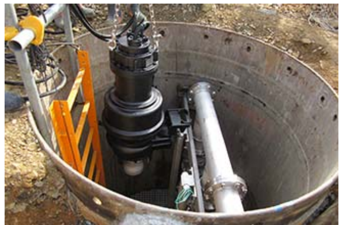
マンホールポンプ(下水を圧送)
