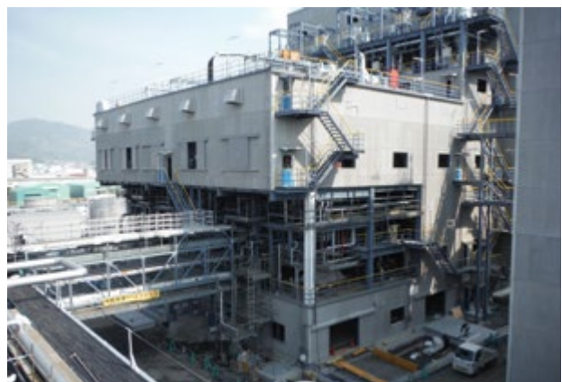
排ガス浄化触媒プラント
