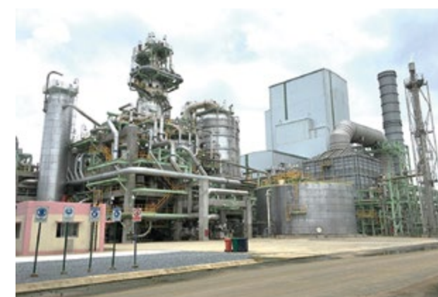
既存ACES21 ® 尿素プラント
