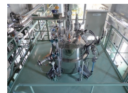
納入した「汚泥熱可溶化装置」
