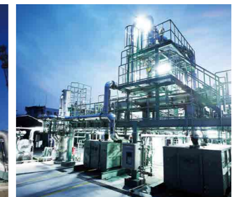
脱水乾燥システム
