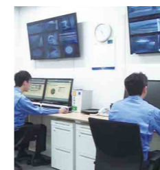
集中監視センター
