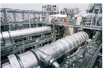
汚泥燃料化設備
