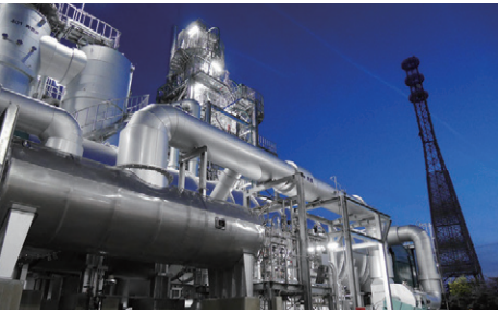
京都市烏羽水環境保全センター 下水污泥固形燃料化設備
