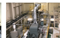
高効率廃熱回収設備 (蒸気タービン)
