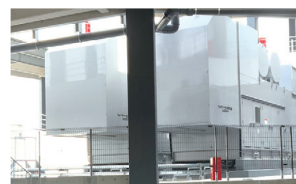
非常用発電機
