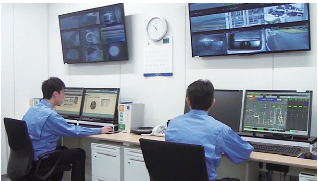
集中監視センター
