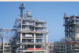
廃液燃焼システム
