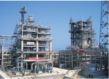
廃液燃焼システム
