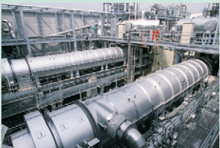
下水汚泥燃料化システム
