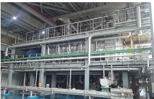
上海・石洞口II期汚泥処理設備
