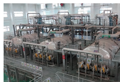
中国・佛山市向け下水汚泥乾燥設備
