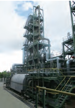
塩酸回収設備
