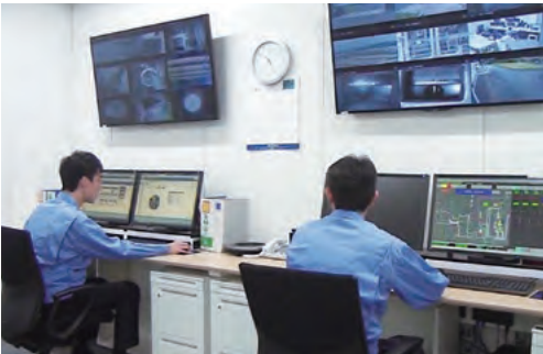
集中監視センター
