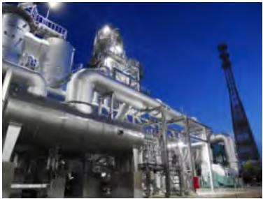
京都市鳥羽水環境保全センター 下水汚泥固形燃料化設備
