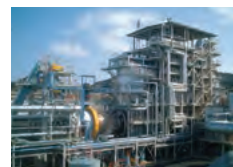
固形廃棄物処理設備
