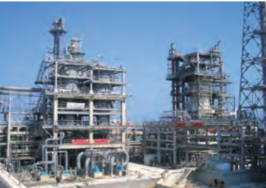
廃液燃焼システム
