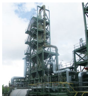
塩酸回収設備
