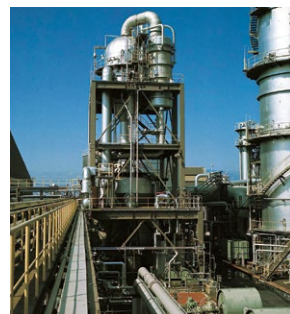
硫安製造設備
