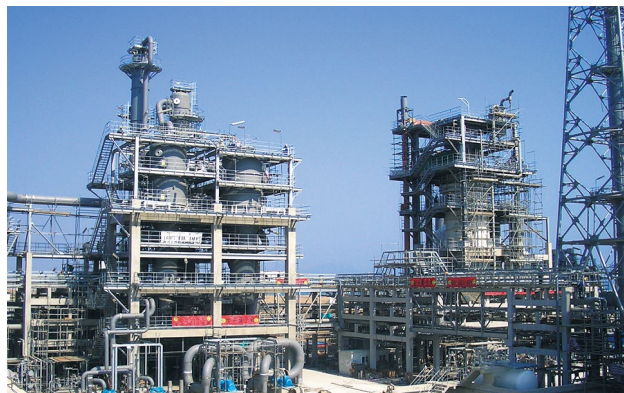
廃液燃焼システム
