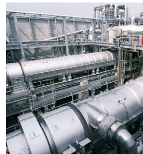
下水汚泥燃料化設備
