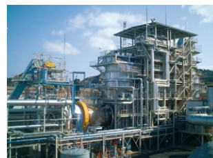
固形廃棄物処理設備
