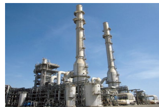
廃液燃焼設備 (サウジアラビア)
