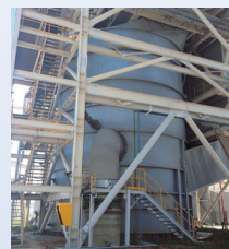
海水法排煙脱硫設備 (モロッコ)
