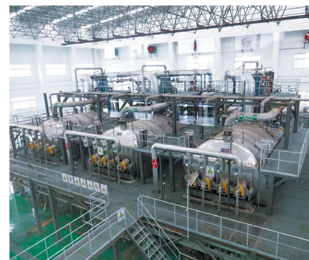
中国・佛山市向け下水汚泥乾燥設備
