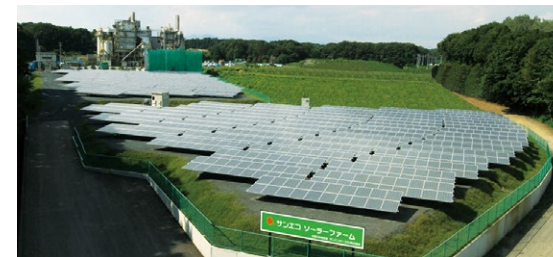
サンエコサーマル(株)太陽光発電設備
