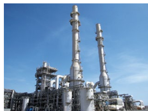
廃液燃焼システム
