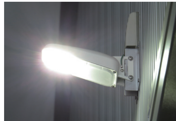
本社工場 照明のLED化
