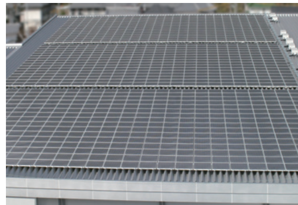
本社工場 太陽光パネル
