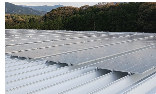
屋上に設置した太陽光パネル
