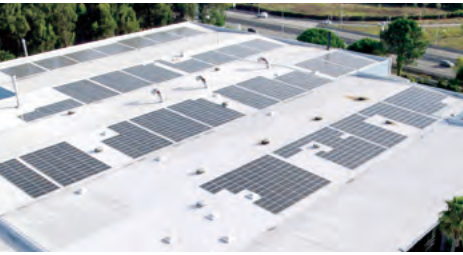
MBOポルトガル工場の太陽光パネル
