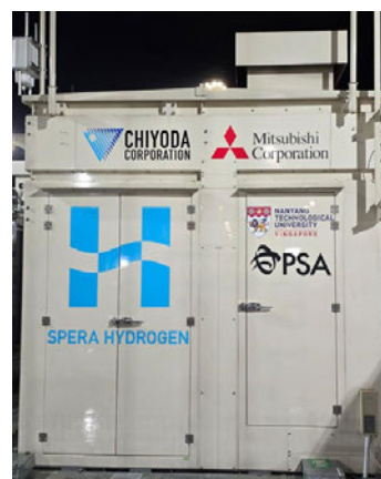
当社が提供した 大型燃料電池車向け小型脱水素装置
