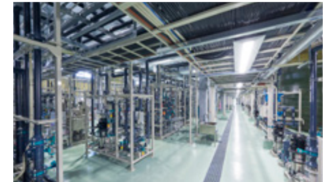
次世代型超純水システム実験棟
