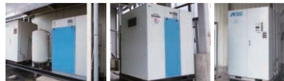
オイルフリースクロールコンプレッサを7台、窒素ガス発生装置を3台分散設置に使用している。
