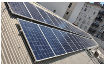
事務所屋上のソーラーパネル
