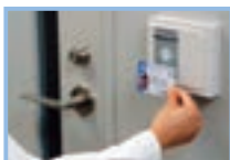
入退室管理システム
