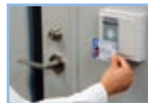
入退室管理システム
