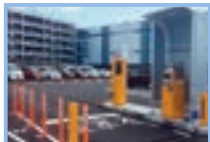
駐車場・駐輪場システム
