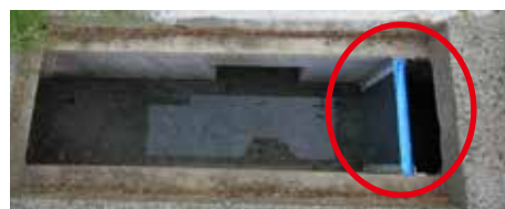
側溝から油水分離槽に至る間に流出経路を分断し回収する対策を施した
