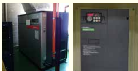
高効率コンプレッサへ更新 (三雲製作所)
