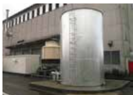
志賀製作所の冷却水循環タンク
