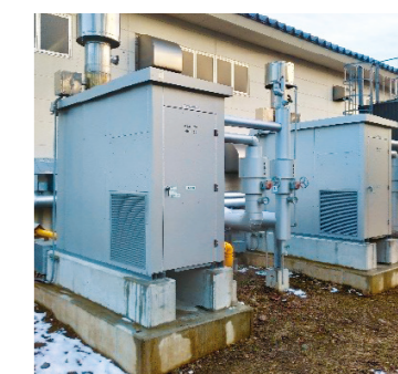
温水ボイラー
