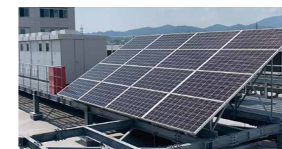
本社屋上設置の太陽光パネル
