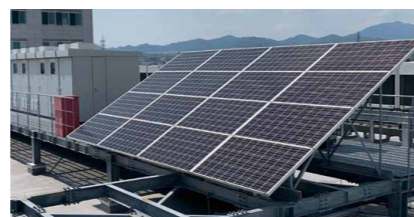
本社屋上設置の太陽光パネル
