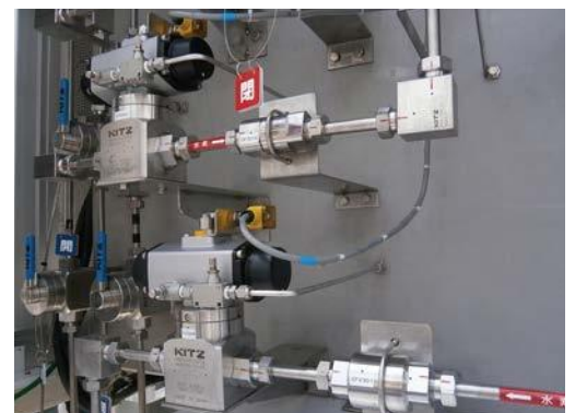
水素ステーション内の配管
