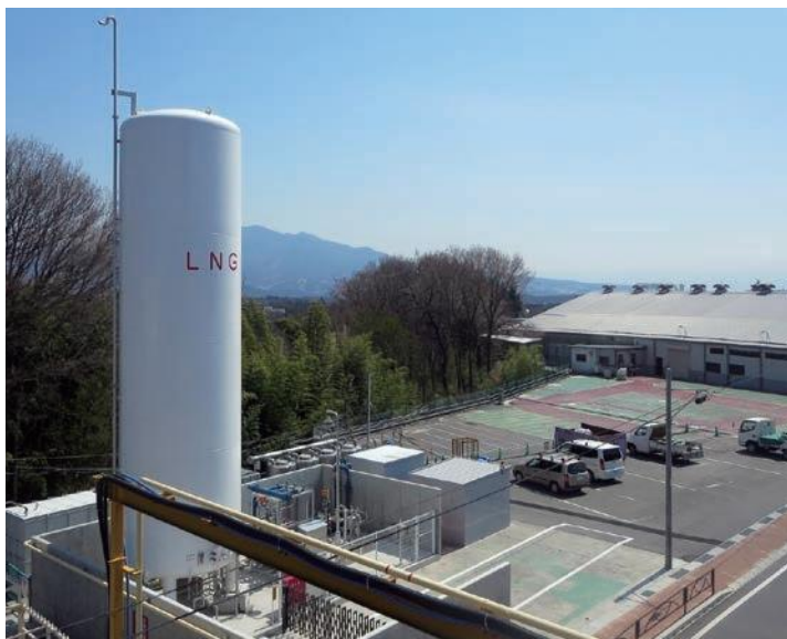
長坂工場 LNG サテライト基地
