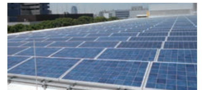
横浜製作所の太陽光発電システム
