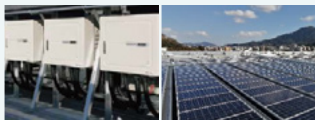
安川テクノロジーセンタ(2021年度開所)に搭載した当社製パワーコンディショナ「Enewell-SOL P2(左)」と「太陽光発電 295kW(右)」
