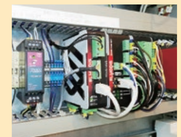
遠隔監視システムの設置例
