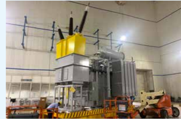
インドで試験し出荷されるグローバル生産変圧器
