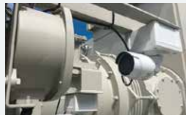
特高変圧器に設置された油温計用カメラ
