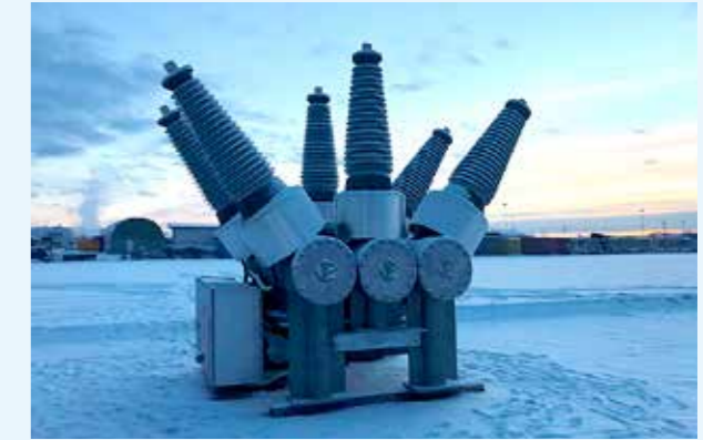
アラスカ州電力協同組合向けに納入した145kVタンク形真空遮断器
