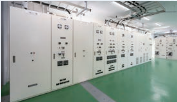
納入した変電機器
