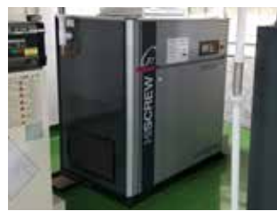
富士山工場 コンプレッサー
