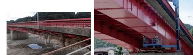
織月大橋(人吉市)の被災状況と点検風景
