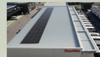
岐阜支店の太陽光パネル
