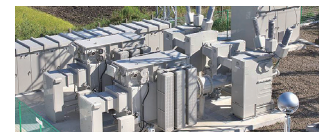
72kV環境配慮型特高受変電設備
