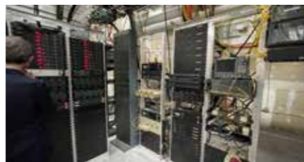
ホテル内のサーバー室に設置されている中継機
