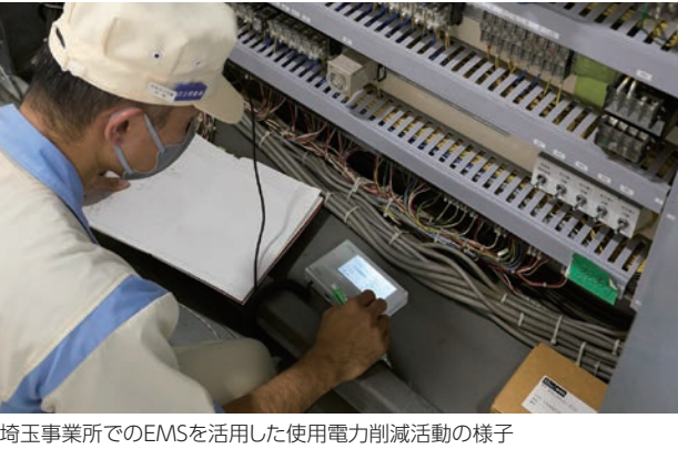
埼玉事業所でのEMSを活用した使用電力削減活動の様子
