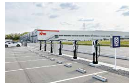
駐車場に設置されたEV充電設備
