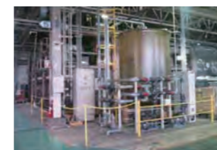
水の循環利用設備
