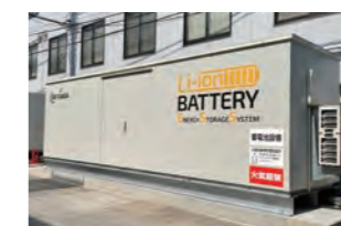
ESSコンテナ外観
