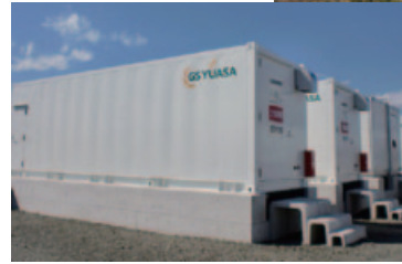
リチウムイオン電池 コンテナ外観
