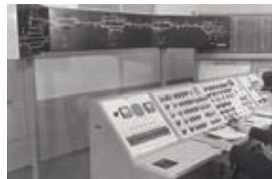
CTCを伊東線に納入・使用開始、 日本国有鉄道におけるCTC第1号機
