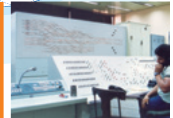
ロカ線 運動操作盤
