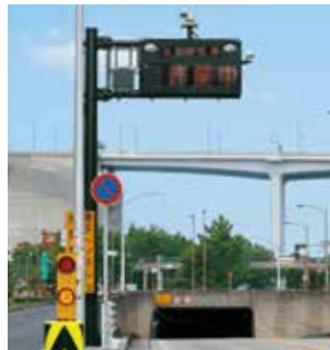
トンネル防災設備
