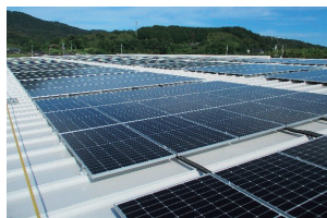
工場の屋根に設置の太陽光パネル
