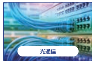
サーバールーム
