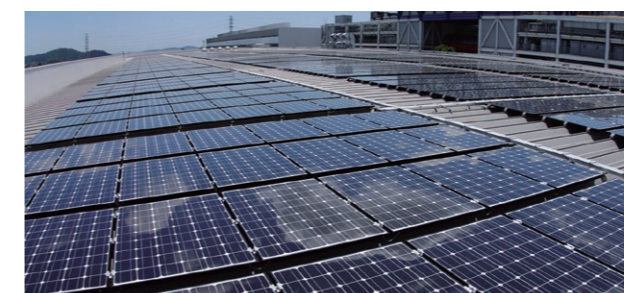
太陽光パネル / 秦野製作所
